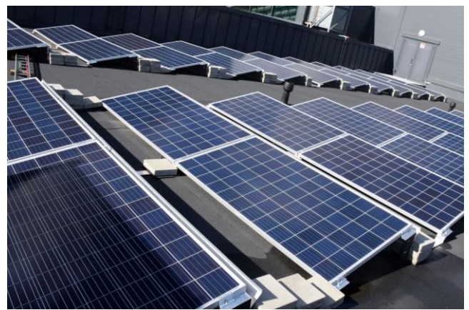
Aurinkopaneelit kauppakeskuksen katolla (Kuva: Yle)
