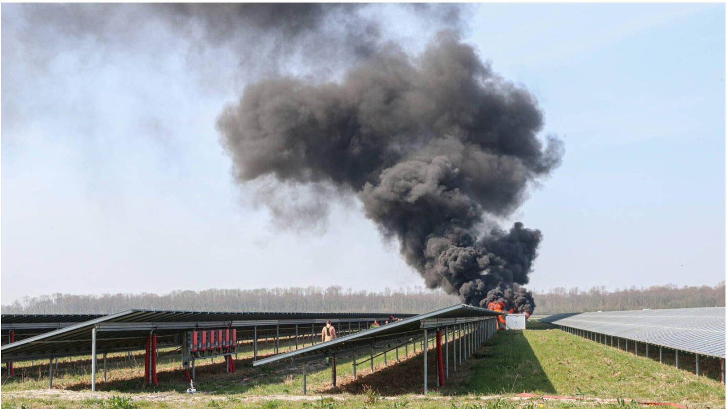
Alla: aurinkosähkövoimalan muuntamon tulipalo Hollannissa Emmeloordissa 8.4.2020 (Kuva: Jeffrey Korte)
