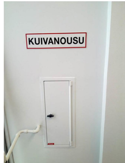
Kuva 2. Porrashuoneessa oleva kuivannousun ulosotto.
