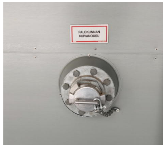
Kuva 1. Selkeästi merkitty ja lukittu palokunnan syöttöliitin.
