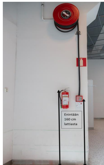
Kuva 9: Sammuttimen kahvan ja pikapalopostin letkun päänsä sijoitus lattiapinnasta
