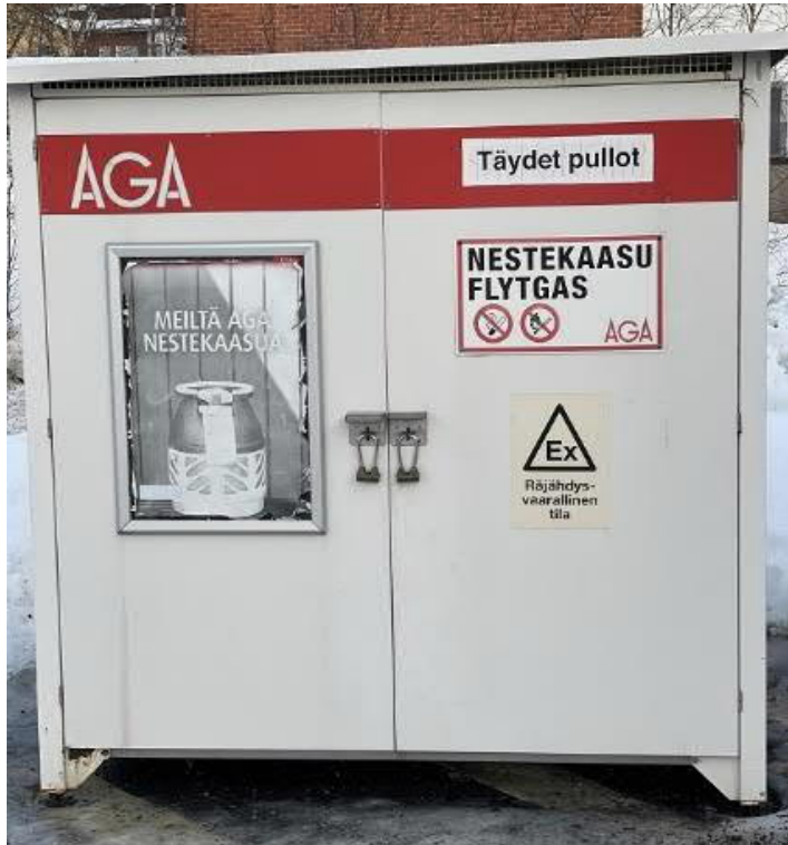
Bild 2. Exempel på ett skåp för flytgasflaskor med låsanordning och alla nödvändiga märkningar.
