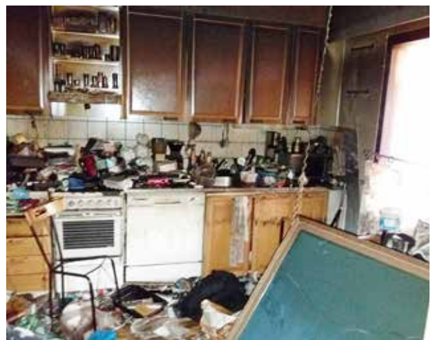
Kuolemaan johtanut tulipalo. Uhrin asunnossa oli suuri määrä roskaa ja muuta palokuormaa.
